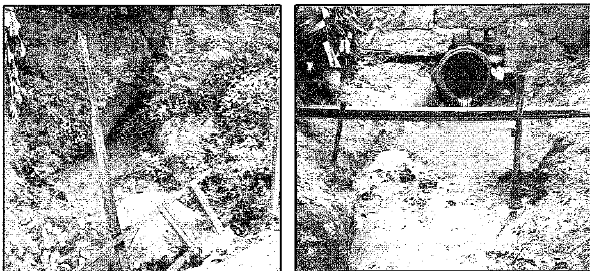
Figura 7.120 – Lançamento irregular de esgoto doméstico no bairro das Damas.
